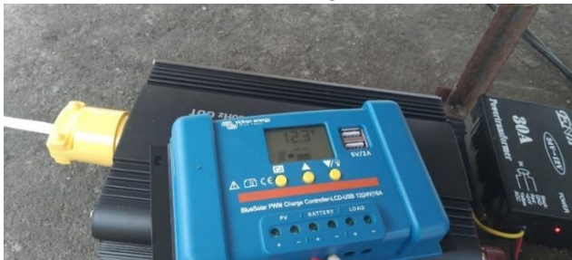
Figura 11. Controlador de carga en funcionamiento con nivel de tensión adecuado
