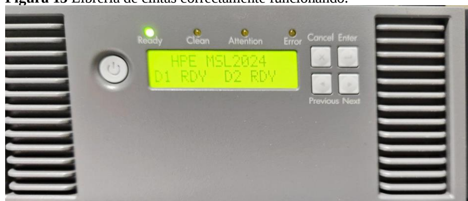
Figura 15 Librería de cintas correctamente funcionando.
