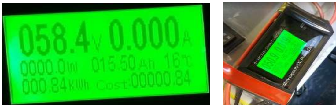
Figura 13 Instrumento de registro de carga y descarga de batería.
