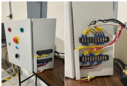
Figura 13 Vista externa del tablero de control.
