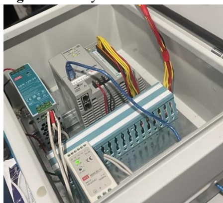
Figura 6 PLC y Fuentes de alimentación en el tablero de Control.
