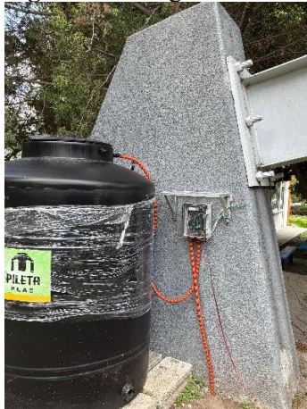
Figura 1. vista general del despliegue, cisterna y gabinete sobre el muro
