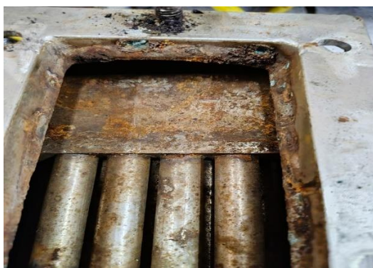
Figura 6. corrosión en tubos
