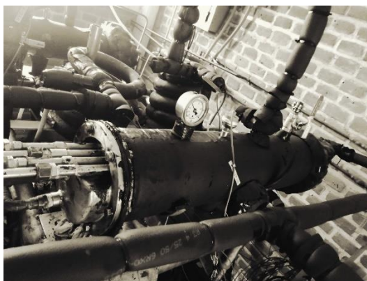
Figura 4. Generador de Calor
