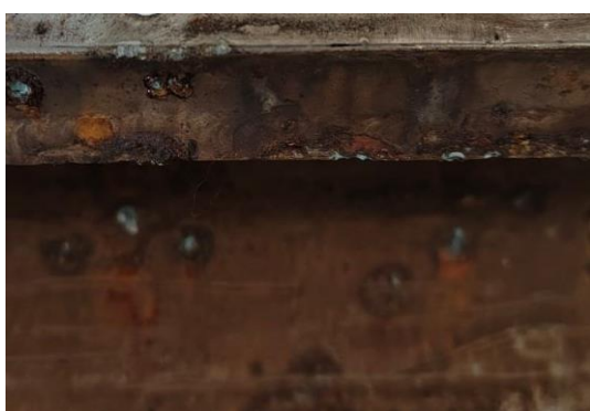
Figura 5. corrosión en carcasa
