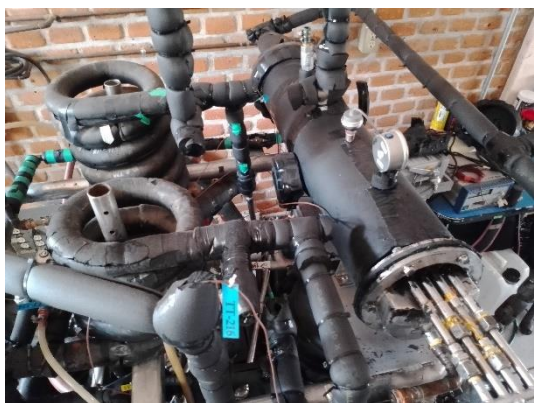
Figura 3. Bomba de Calor
