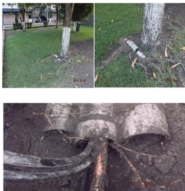
Figura 4. Raíz encontrada en tuberías de asbestocemento.
