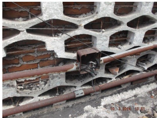
Figura 1. Tuberías, cableados, cajas de conexión y empalmes totalmente obsoletos y fuera de normatividad, en la parte superior del pasillo del edificio F.
